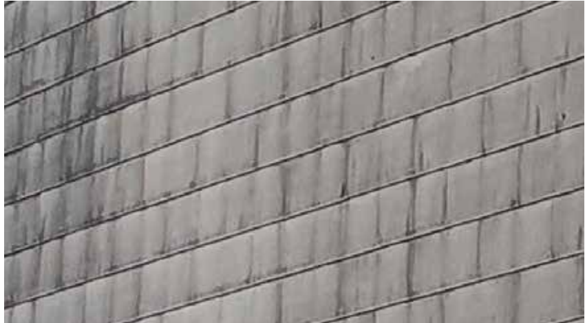
Missstand Beispiel: Materialität der Fassade
