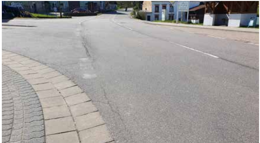
Misstand: unzureichende Gestaltung der Ortsdurchfahrt „Zur Hilt“ (L 170)
