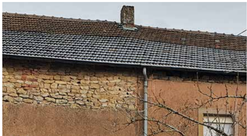
Modernisierungs- und instandsetzungsbedürftiges Gebäude mit hohem Bedarf
