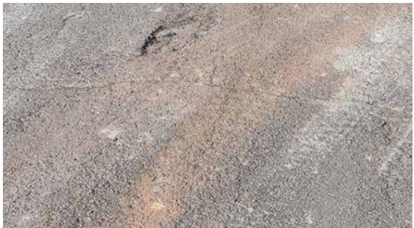
Misstand: sanierungsbedürftige Fahrbahndecken im Bereich der Straße „Katzenberg“
