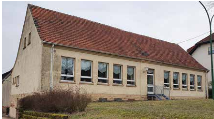
Bürgerhaus inkl. Gebäudevorflächen mit Sanierungs- und Aufwertungsbedarf im Bereich der Straße „Zum Saargau“
