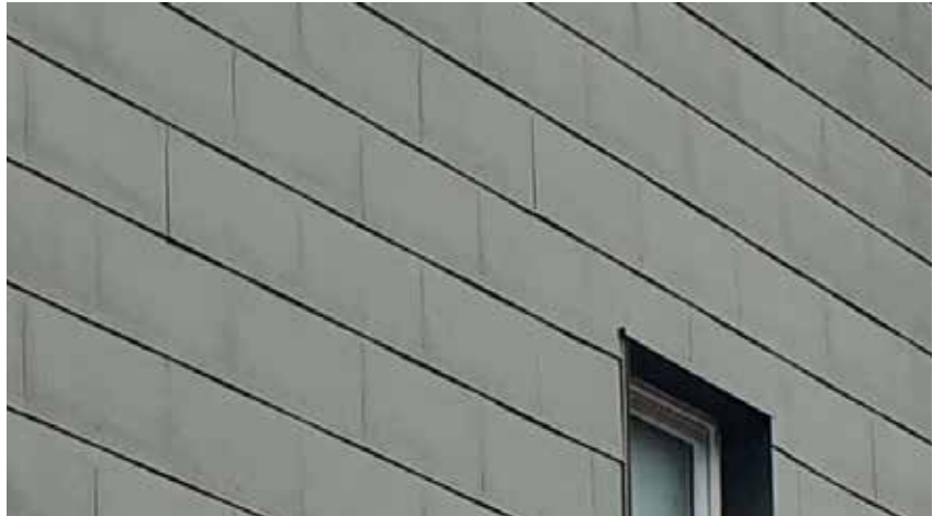
Missstand Beispiel: Materialität der Fassade
