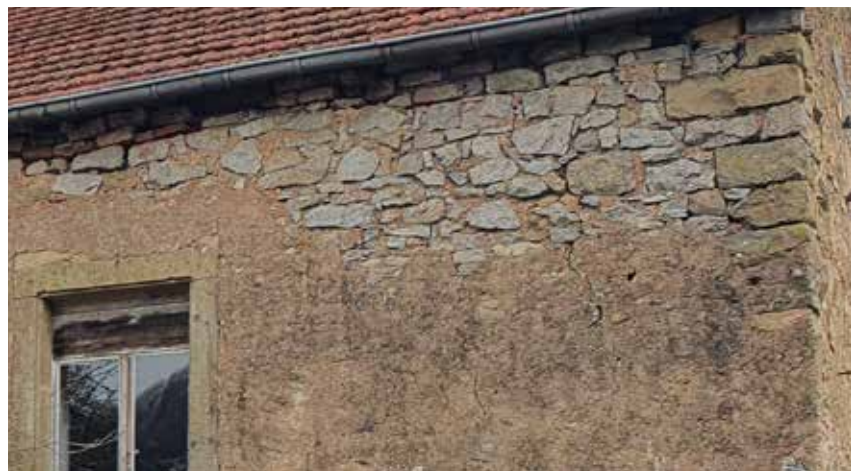
Modernisierungs- und instandsetzungsbedürftiges Gebäude mit hohem Bedarf
