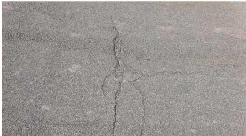
Missstand: sanierungsbedürftige Fahrbahndecken im Bereich der Straße „Zum Adelsberg“
