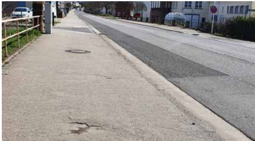
Misstand: unzureichende Gestaltung der ehem. Bundesstraße „Bezirkstraße“
