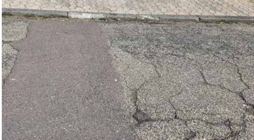
Misstand: sanierungsbedürftige Fahrbahndecken im Bereich der Ponterstraße
