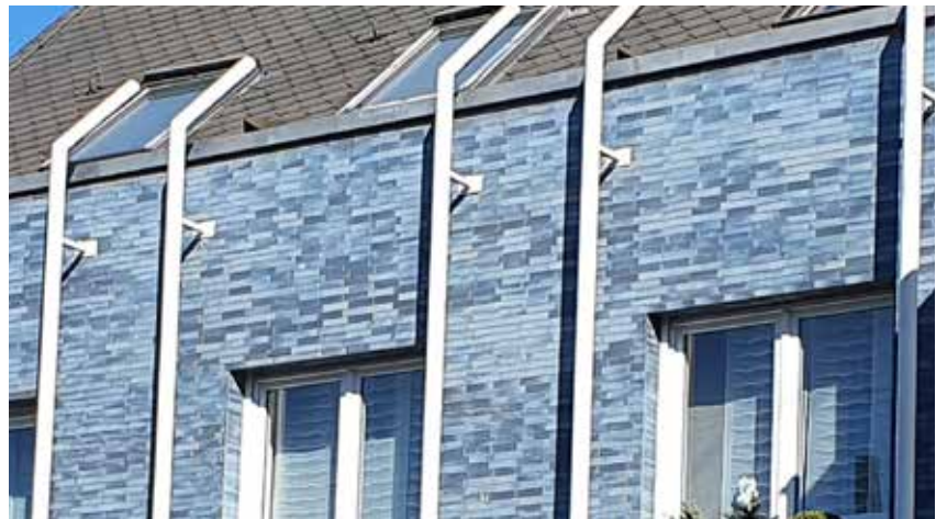
Missstand Beispiel: Gestaltung und Gliederung der Fassaden
