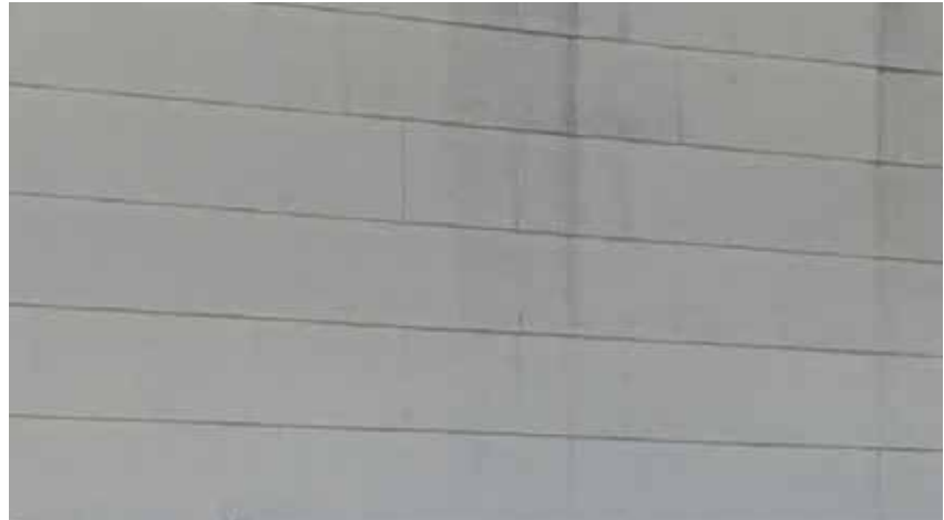
Missstand Beispiel: Materialität der Fassade
