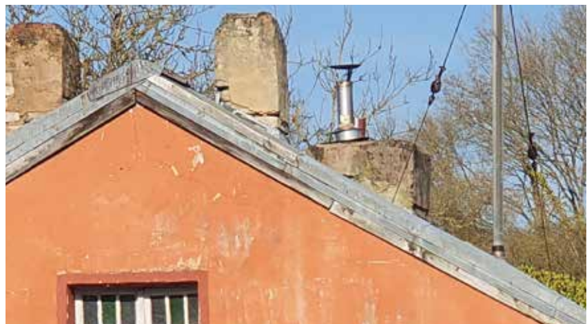
Modernisierungs- und instandsetzungsbedürftiges Gebäude mit hohem Bedarf
