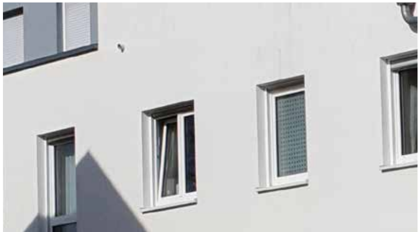
Modernisierungs- und instandsetzungsbedürftiges Gebäude mit geringem Bedarf
