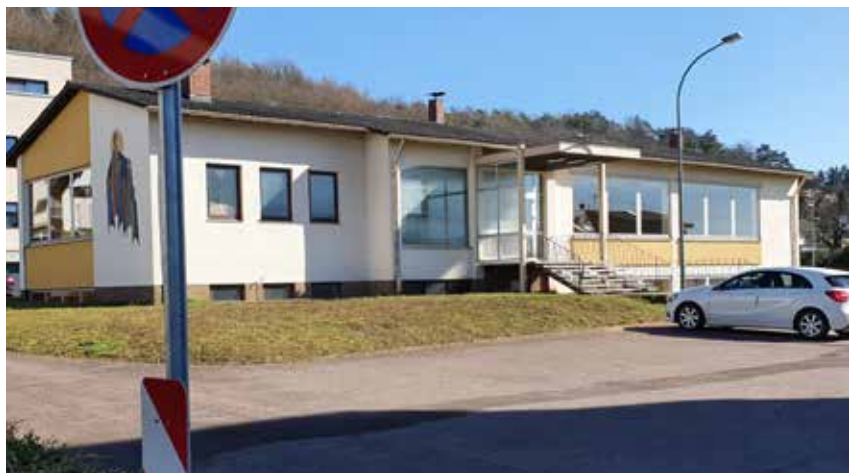
Bürgerhaus mit integriertem Gastronomiebetrieb (oben) sowie kath. Pfarr- und Jugendheim (unten) mit Sanierungs- und Aufwertungsbedarf im Bereich der Pastor-Krayer-Straße
