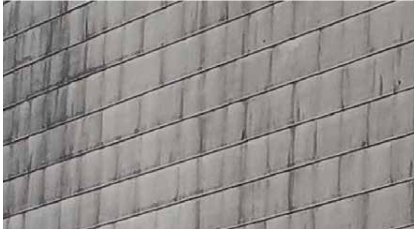
Missstand Beispiel: Materialität der Fassade
