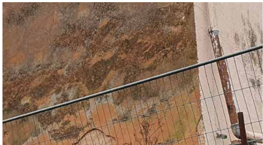
Modernisierungs- und instandsetzungsbedürftiges Gebäude mit hohem Bedarf
