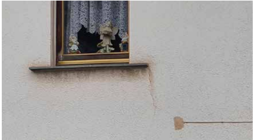
Modernisierungs- und instandsetzungsbedürftiges Gebäude mit mittlerem Bedarf
