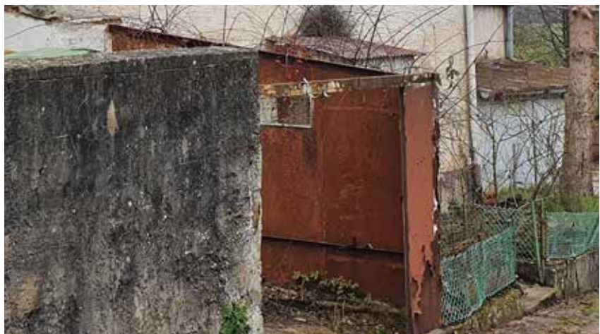
Ortsbildbeeinträchtigende Gestaltung von Gebäudevorflächen/ Nutzung unbebauter Grundstücksflächen
