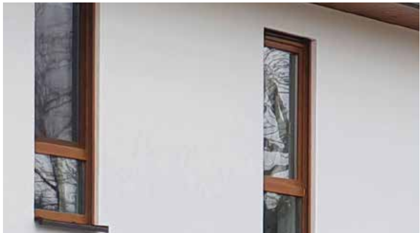
Modernisierungs- und instandsetzungsbedürftiges Gebäude mit geringem Bedarf
