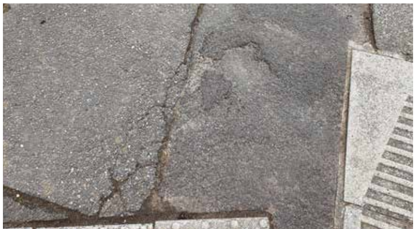
Missstand: sanierungsbedürftiger Bürgersteig im Bereich der Ortsdurchfahrt „Luxemburger Straße“ (L 170)
