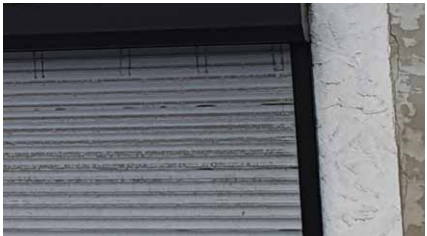
Misstand Beispiele: Materialität der Fassade/ von Garagentoren
