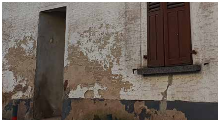
Modernisierungs- und instandsetzungsbedürftiges Gebäude mit hohem Bedarf
