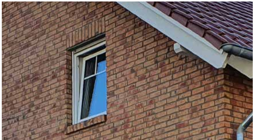
Modernisierungs- und instandsetzungsbedürftiges Gebäude mit geringem Bedarf
