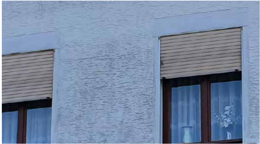
Modernisierungs- und instandsetzungsbedürftiges Gebäude mit mittlerem Bedarf
