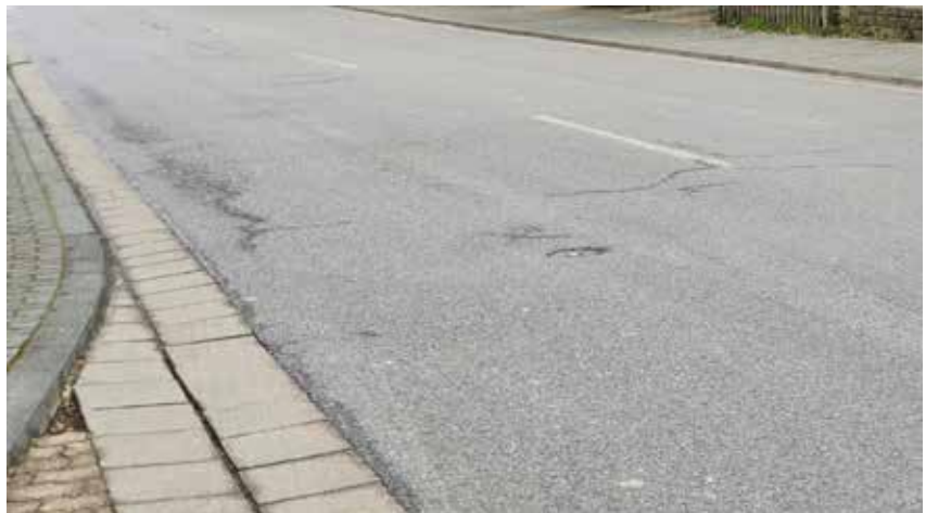
Misstand: unzureichende Gestaltung der Ortsdurchfahrt „Honzrather Straße“ (L 346)
