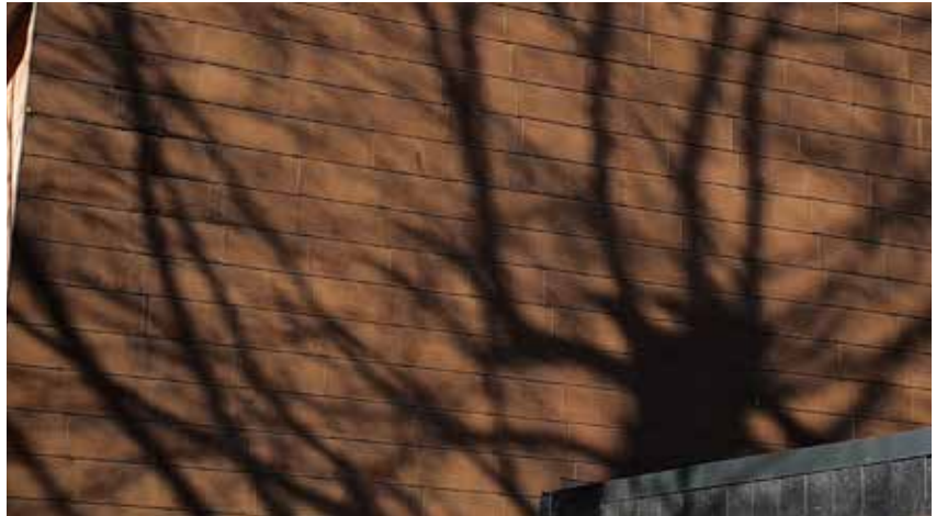
Misstand Beispiele: Materialität der Fassade
