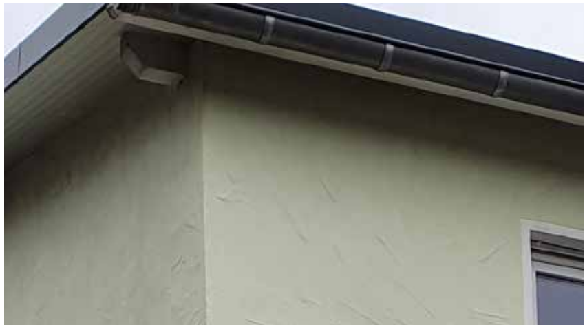
Modernisierungs- und instandsetzungsbedürftiges Gebäude mit geringem Bedarf
