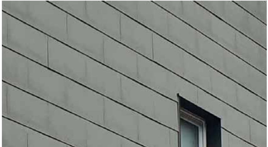
Missstand Beispiel: Materialität der Fassade
