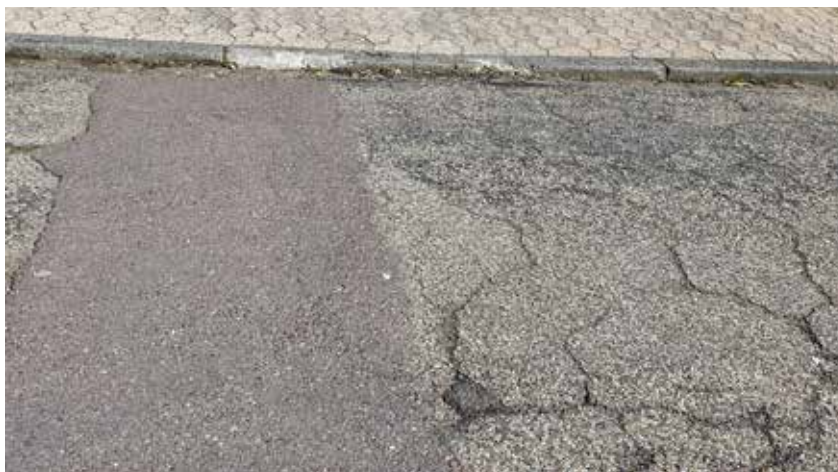
Misstand: sanierungsbedürftige Fahrbahndecken im Bereich der Ponterstraße
