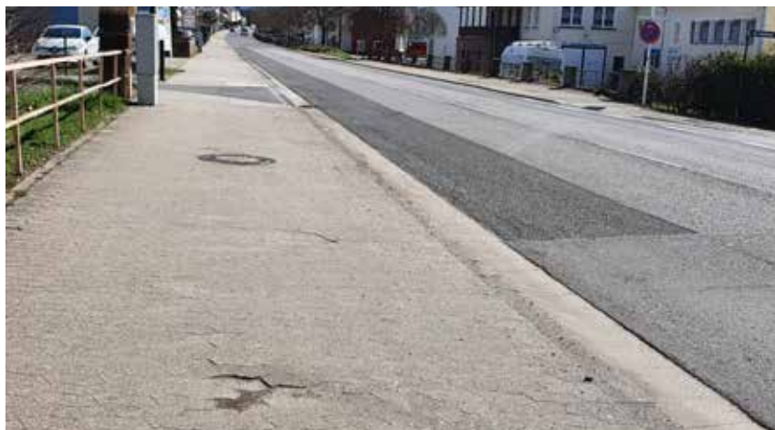
Misstand: unzureichende Gestaltung der ehem. Bundesstraße „Bezirkstraße“
