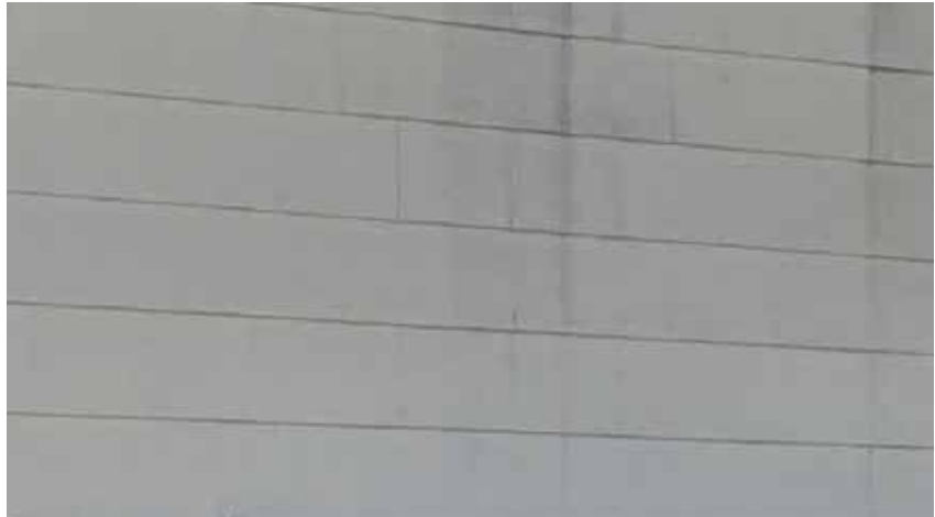
Missstand Beispiel: Materialität der Fassade
