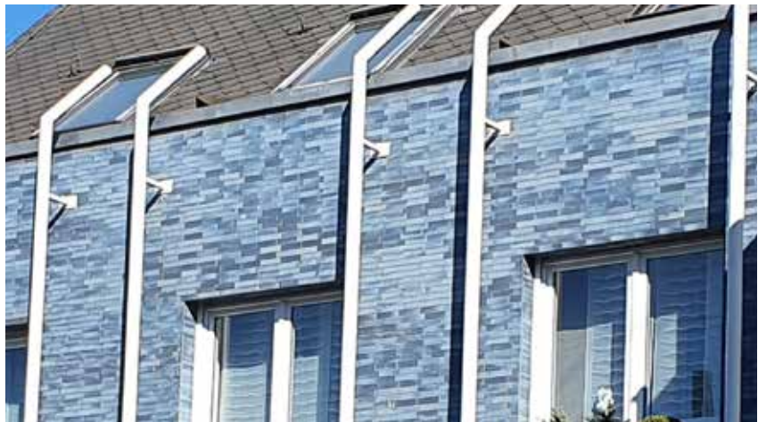
Missstand Beispiel: Gestaltung und Gliederung der Fassaden
