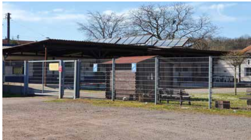
Bereich am Sportplatz (u.a. Clubheim inkl. Vorflächen) mit Sanierungs- und Aufwertungsbedarf
