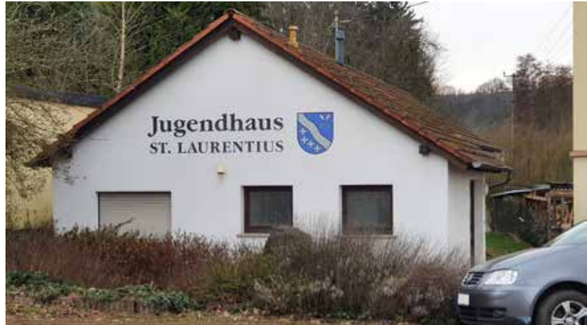
sanierungs- und aufwertungsbedürftiges Jugendhaus samt Hoffläche im Bereich der Ortsdurchfahrt „Luxemburger Straße“ (L 170)
