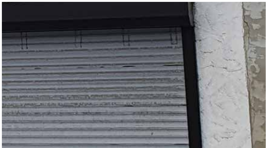
Misstand Beispiele: Materialität der Fassade/ von Garagentoren
