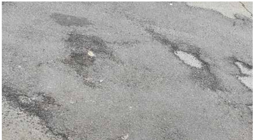
Missstand: sanierungsbedürftige Fahrbahndecken im Bereich der Straße „Im Ecken“
