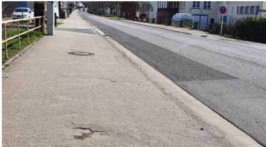
Misstand: unzureichende Gestaltung der ehem. Bundesstraße „Bezirkstraße“
