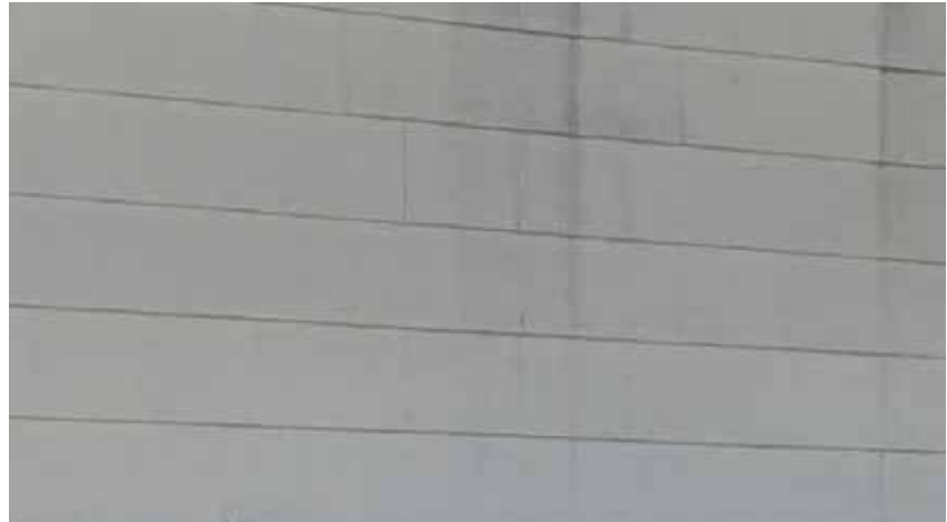
Missstand Beispiel: Materialität der Fassade
