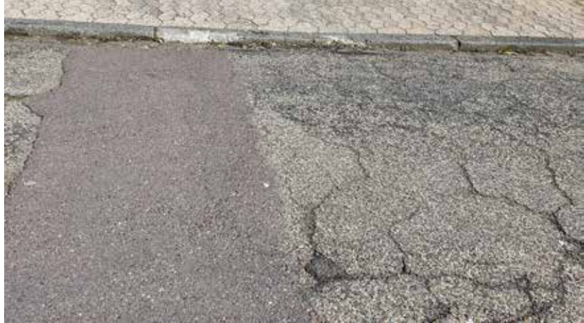
Misstand: sanierungsbedürftige Fahrbahndecken im Bereich der Ponterstraße
