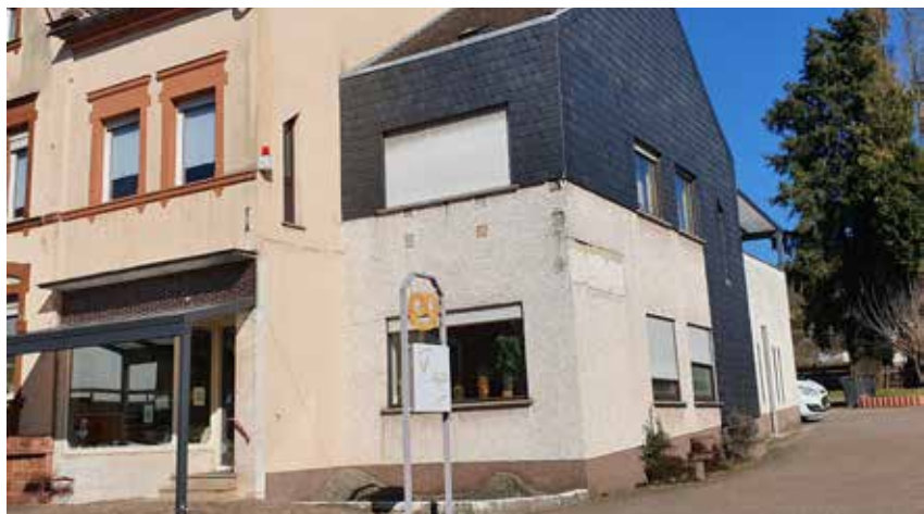
Bäckerei mit Sanierungs- und Aufwertungsbedarf im Bereich der ehem. Bundesstraße „Bezirkstraße“
