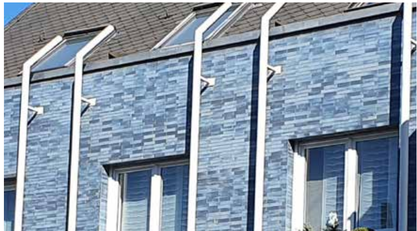
Missstand Beispiel: Gestaltung und Gliederung der Fassaden
