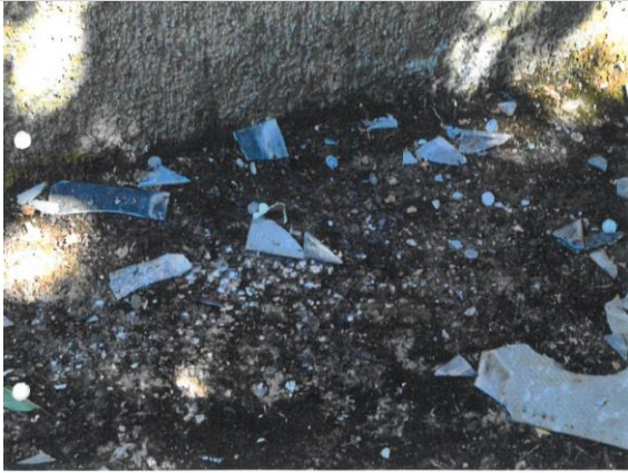
Rückbau von Asbestfaserzementfassadenplatten unter Missachtung der Vorgaben der TRGS 519
