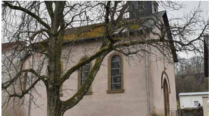
Denkmalgeschützte „Alte Kapelle“ mit Sanierungs- und Aufwertungsbedarf im Bereich der Lilienstraße
