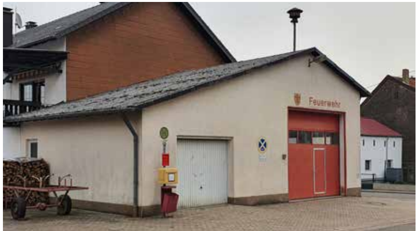
Feuerwehrgerätehaus mit Sanierungsbedarf im Bereich der beiden Kapellen
