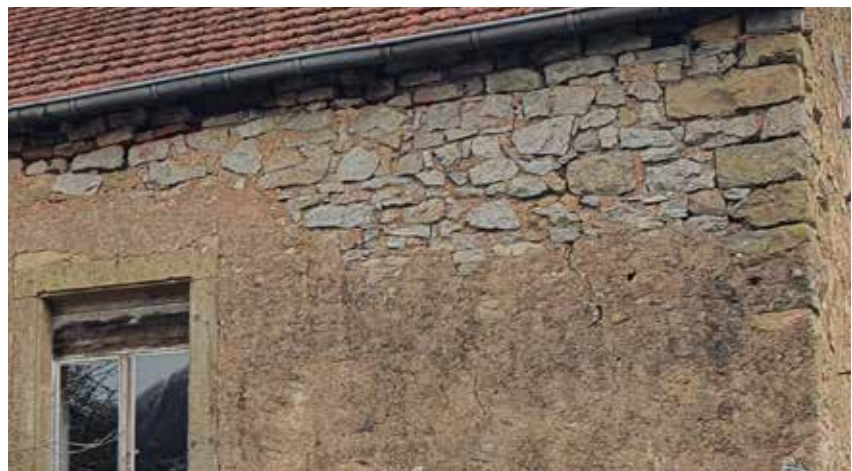
Modernisierungs- und instandsetzungsbedürftiges Gebäude mit hohem Bedarf
