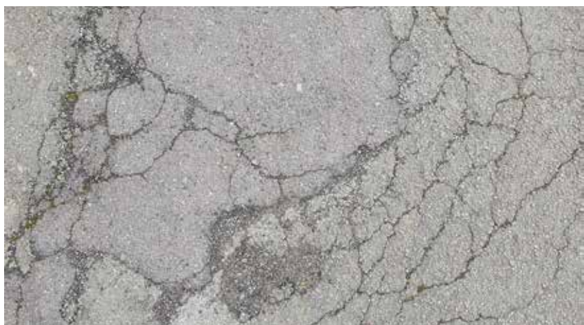
Misstand: sanierungsbedürftige Fahrbahndecken im Bereich der Straße „Zum Hüttental“
