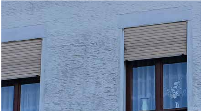
Modernisierungs- und instandsetzungsbedürftiges Gebäude mit mittlerem Bedarf
