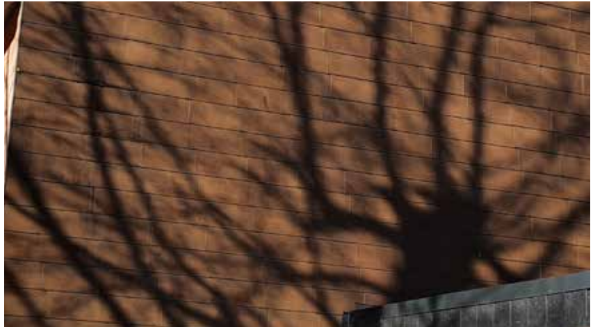
Misstand Beispiele: Materialität der Fassade
