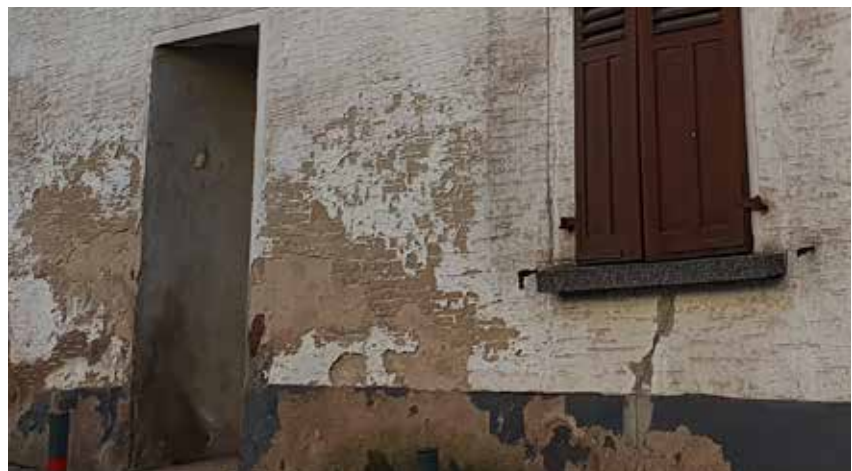
Modernisierungs- und instandsetzungsbedürftiges Gebäude mit hohem Bedarf
