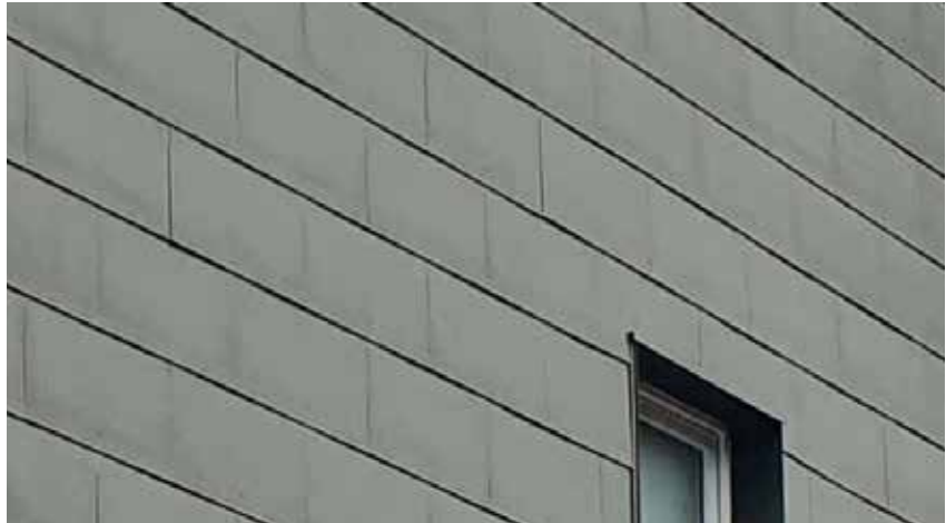
Missstand Beispiel: Materialität der Fassade
