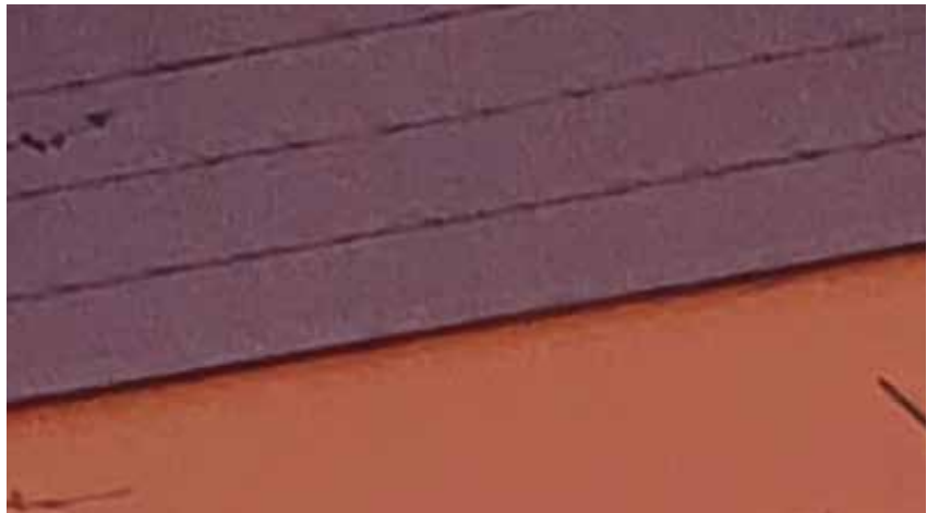
Missstand Beispiel: Farbgebung der Fassade
