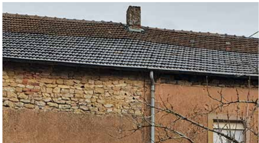
Modernisierungs- und instandsetzungsbedürftiges Gebäude mit hohem Bedarf
