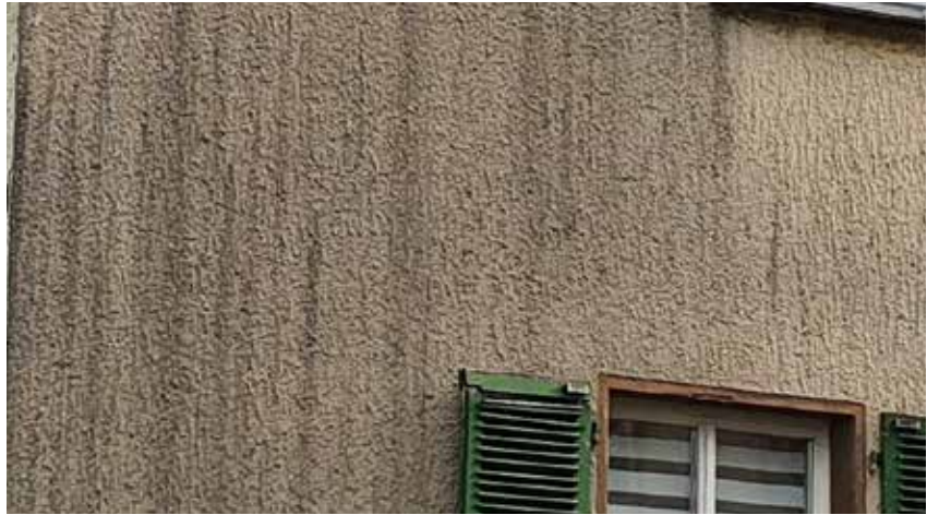
Modernisierungs- und instandsetzungsbedürftiges Gebäude mit mittlerem Bedarf
