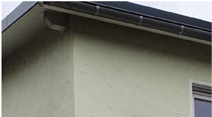
Modernisierungs- und instandsetzungsbedürftiges Gebäude mit geringem Bedarf
