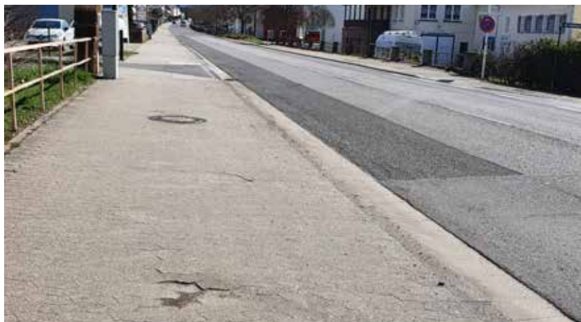
Misstand: unzureichende Gestaltung der ehem. Bundesstraße „Bezirkstraße“
