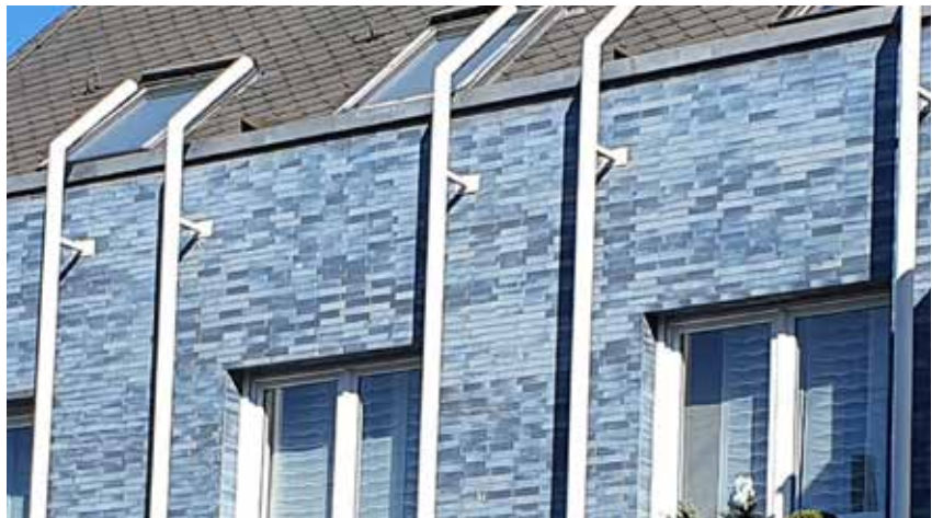
Misstand Beispiel: Gestaltung und Gliederung der Fassaden
