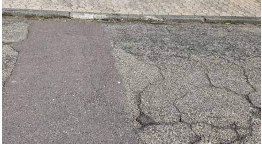
Misstand: sanierungsbedürftige Fahrbahndecken im Bereich der Ponterstraße
