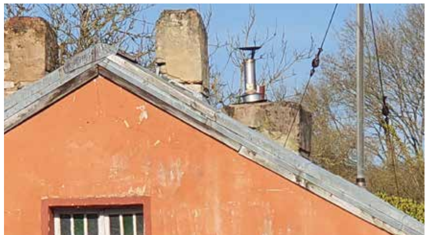
Modernisierungs- und instandsetzungsbedürftiges Gebäude mit hohem Bedarf
