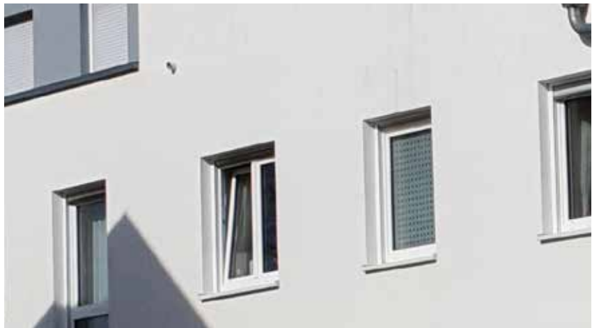
Modernisierungs- und instandsetzungsbedürftiges Gebäude mit geringem Bedarf
