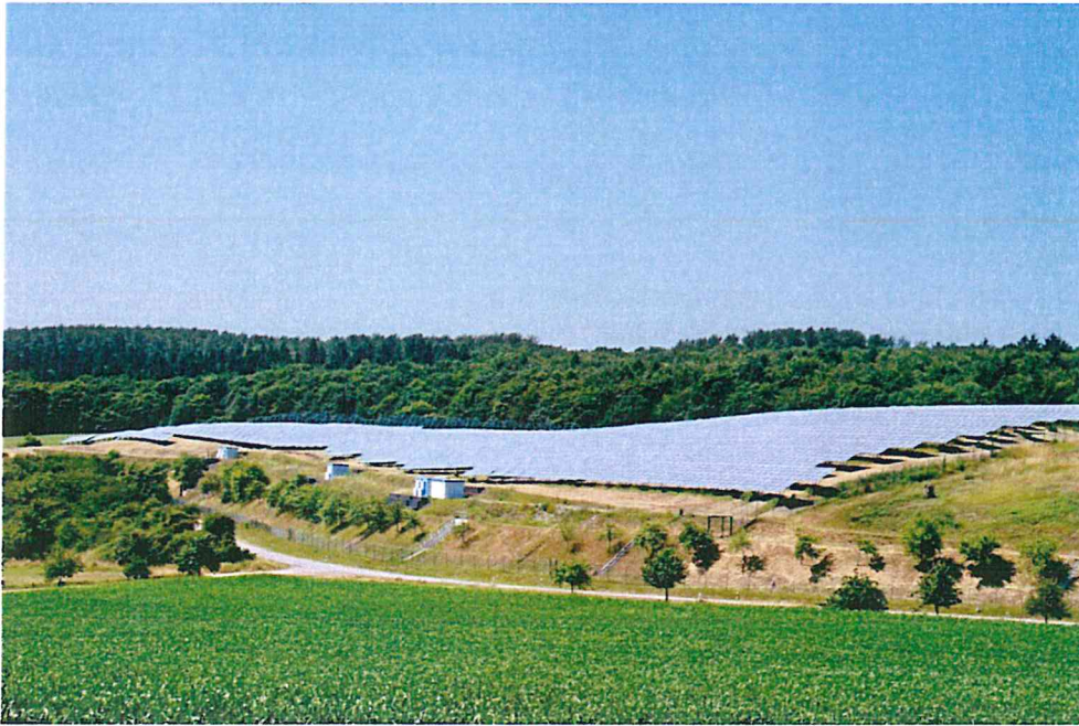
Bild 1: Solarpark auf der Deponie Fitten
