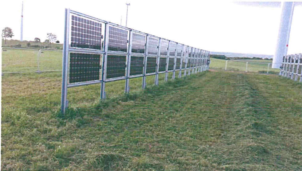
Bild 3: Pilotanlage in Losheim am See
